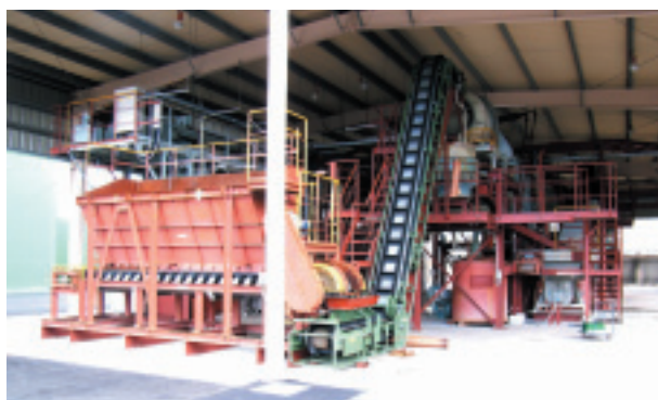
汚染土壌洗浄装置
